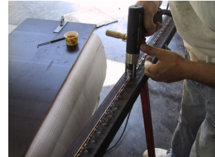
Anbringen von Gewindestiften auf der Stahlkante mit Bolzenschweißgerät Fitting set screws on steel edge with bolt welding machine
